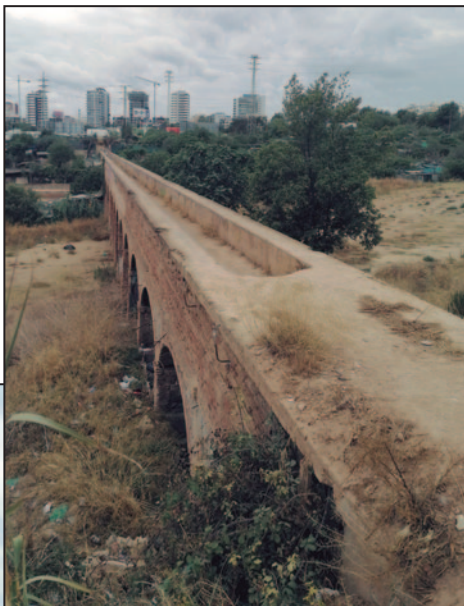
Aqüeducte de Cornellà al Barranc de Can Clota. Des del pàrquing Avd. Electricitat 3, d'Esplugues de Llobregat.
