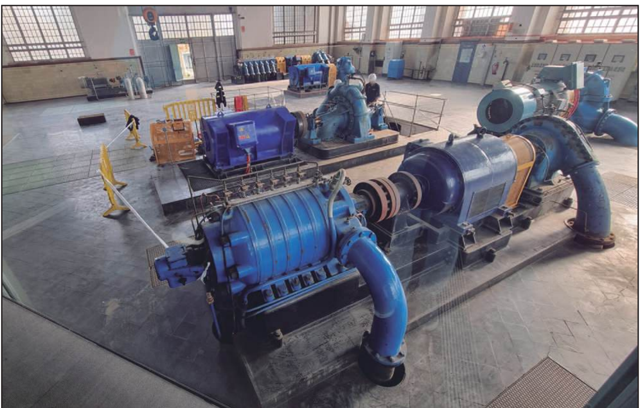
Sala de Màquines
