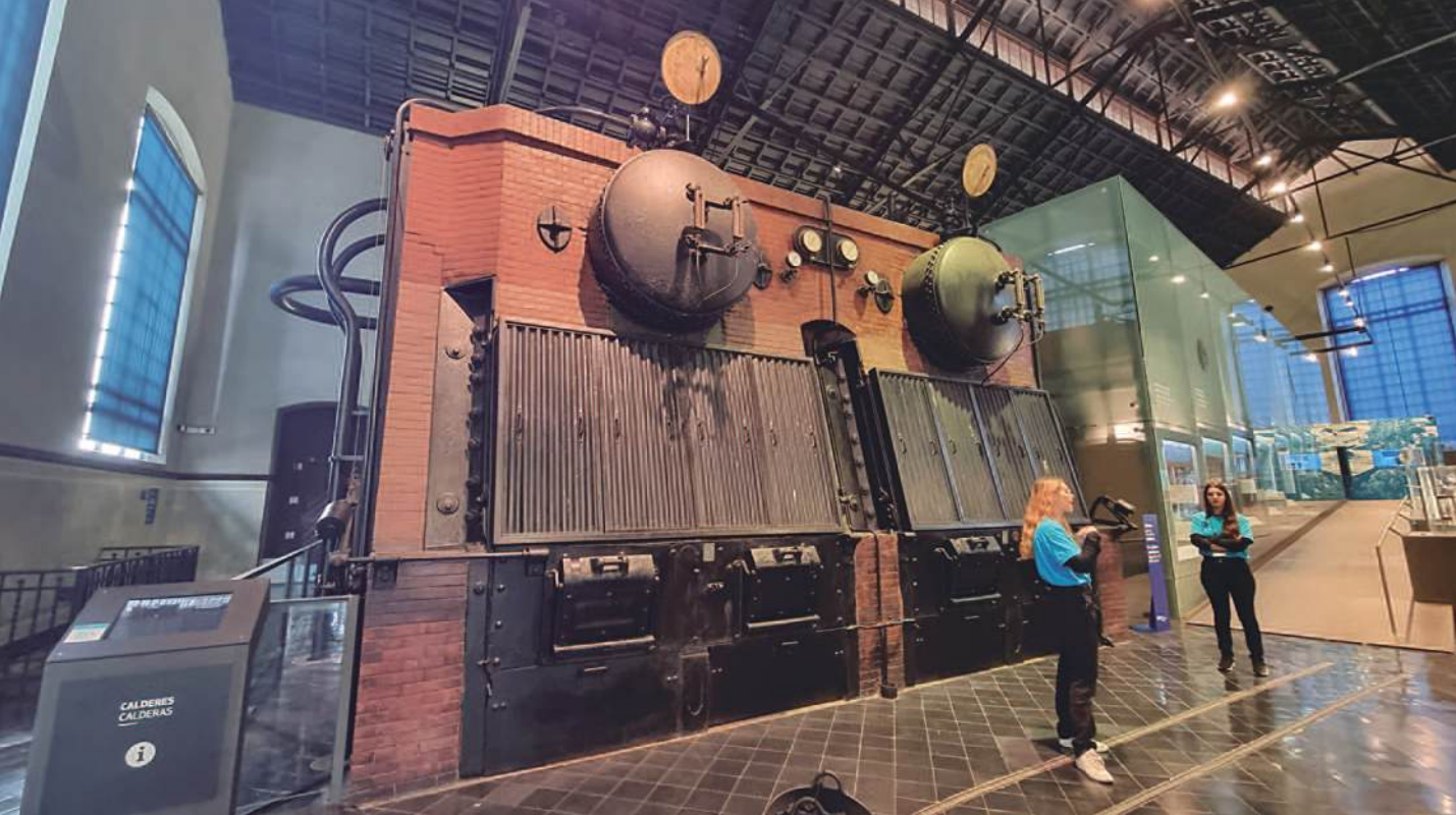
Sala de Calderes
