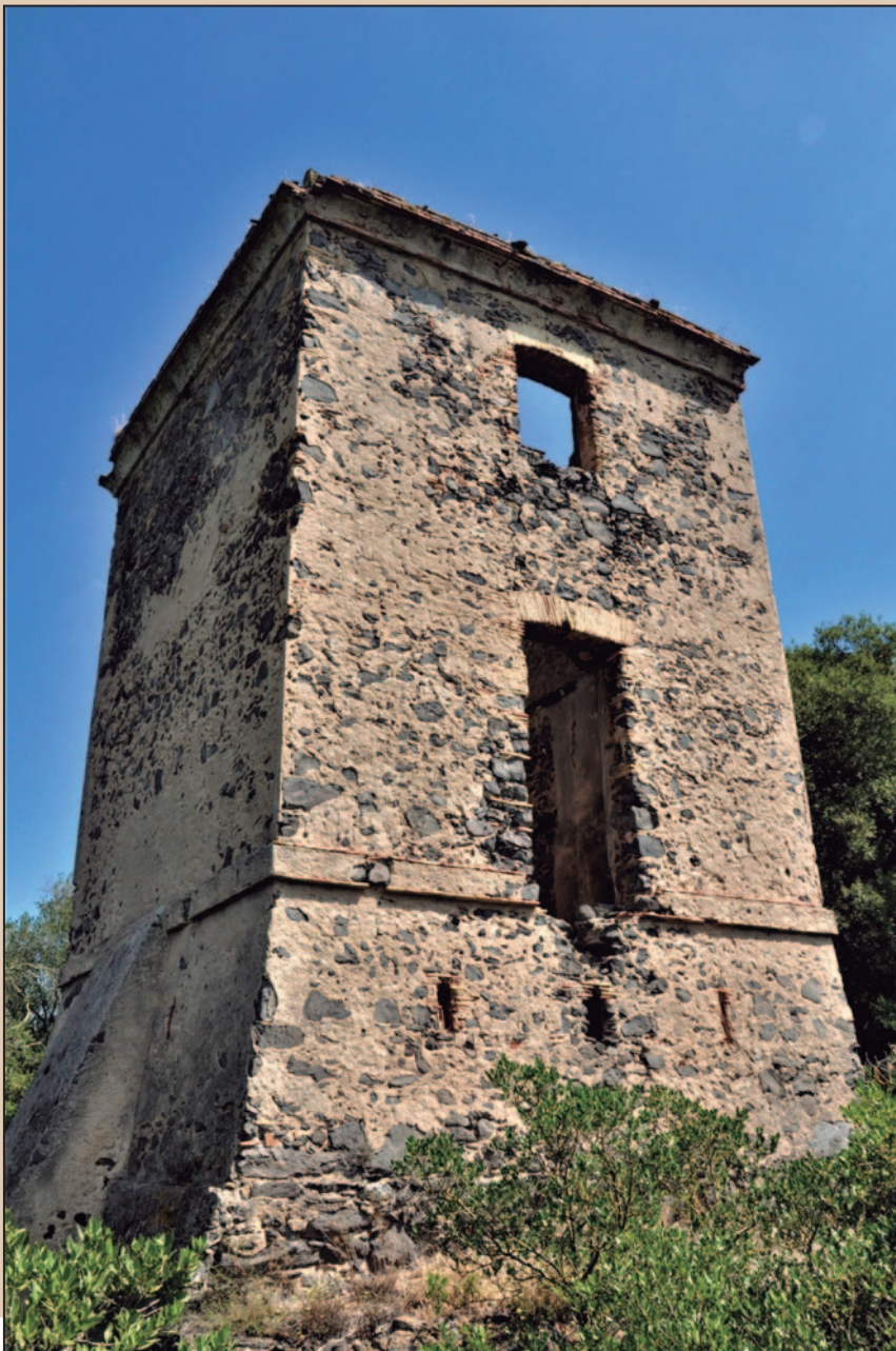
Torre telegrafia civil de Puigsardina, a Riudarenes (Selva), en mal estat de conservació.
